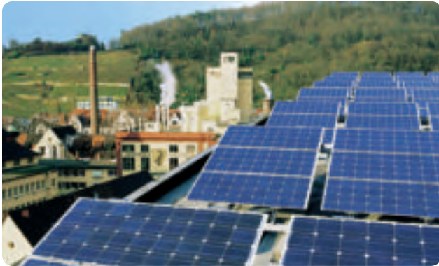
Brauerei Ganter, 70 kWp, Freiburg i.Br.
